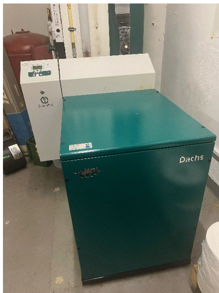
BHKW im Rathaus
